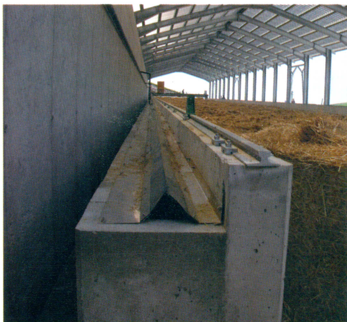
▼ Un particolare della vasca con i liquami. È coperta per evitare la diffusione di odori.
