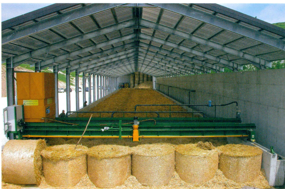
▼ Un'immagine del Biodigestore CFL Modil da una testata. La vasca è lunga 80 metri e larga 10. In primo piano il carrozzone che scorre longitudinalmente sopra la vasca, trasversalmente si muove il castello che provvede, con il movimento delle coclee, alla movimentazione e all'arieggiamento della biomassa. La vasca è delimitata da due muretti laterali alti 130 cm. Quello a destra nell'immagine contiene la vasca entro la quale le pompe inviano il liquame proveniente dalle fosse di stoccaggio. Non passa inosservata la copertura, necessariamente rinforzata per essere a prova di nevicate invernali. Putrelle in acciaio e doppia capriata. L'altezza minima laterale è di 4,75 metri e quella massima centrale 6.
